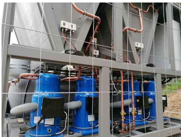
Zdjęcie 8 Agregat wody lodowej
