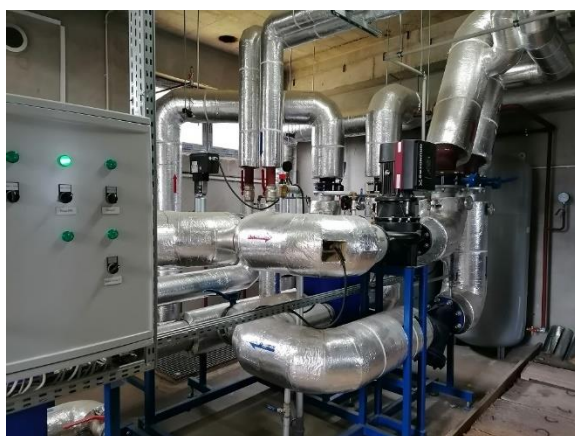
Zdjęcie 6 Węzłowe wymienniki ciepła
